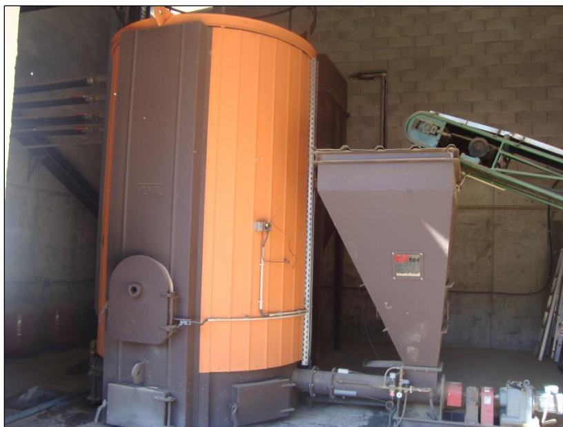
Figura 8- Caldeira de biomassa
